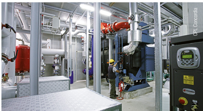
Tutte le attività di gestione, conduzione e manutenzione degli impianti termici per la Città Metropolitana di Napoli e per il Comune di Napoli sono oggi affidati a CPL Concordia
